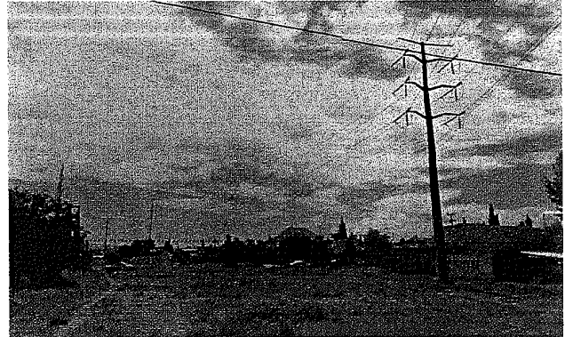
Fig. 48 Línea de 115Kva en el Área de Estudio. 58
