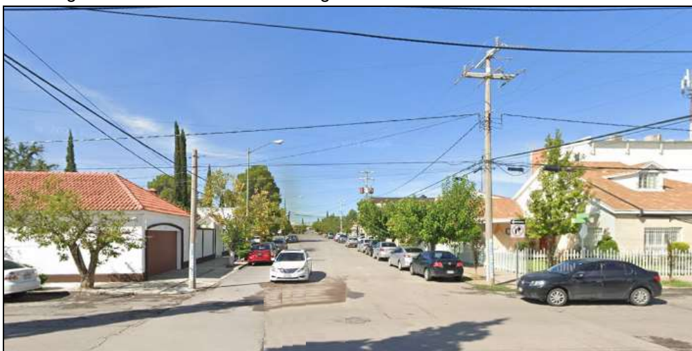
Imagen 45. Infraestructura de energía eléctrica en calle Blas cano de los Ríos.
