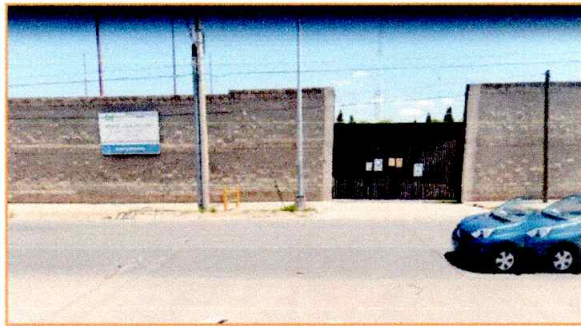
Imagen 19. Subestación Eléctrica Ocampo. Líneas de transmisión eléctrica de alta y media tensión. Fotografía Propia.
