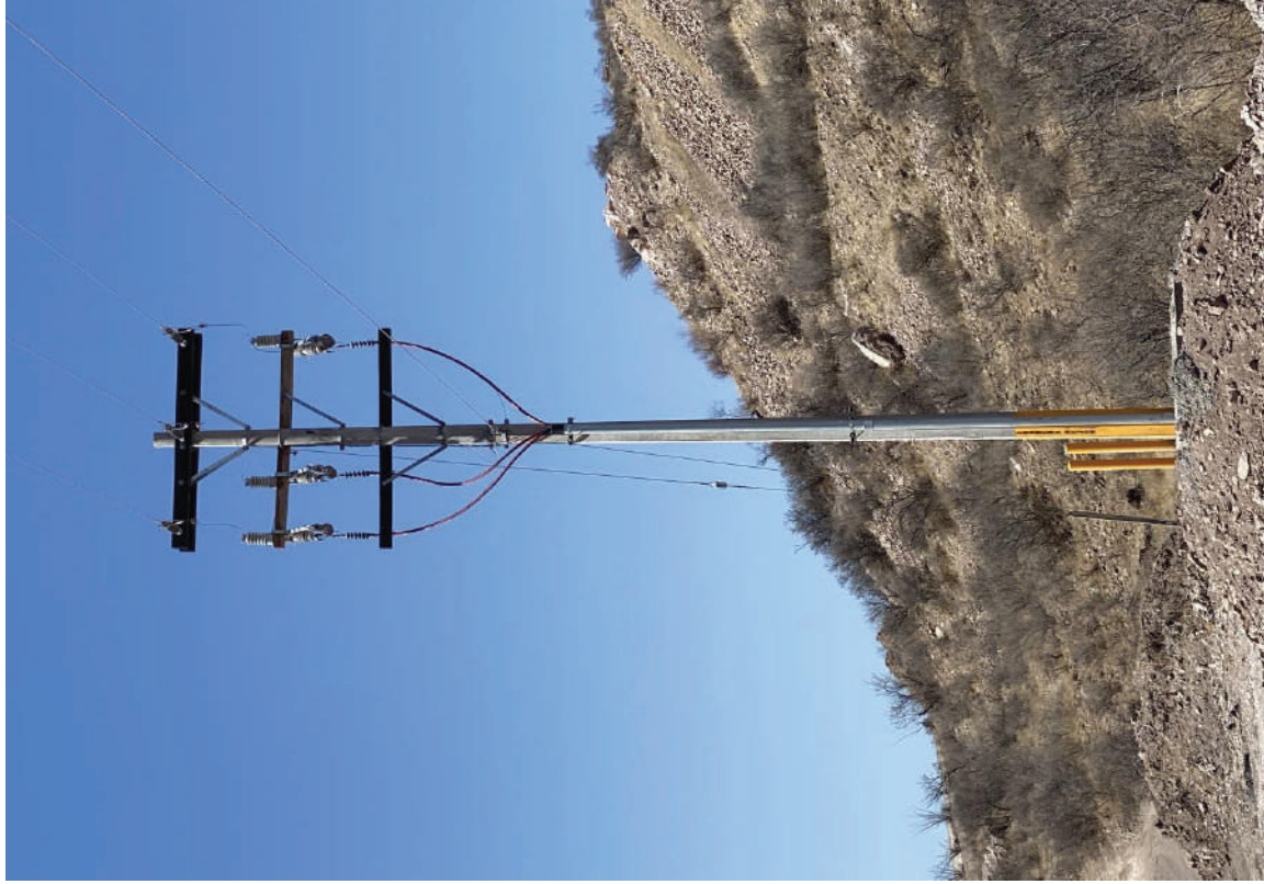
Figura 202. Punto de conexión de energía eléctrica existente en las coordenadas latitud 28°36'29.46" N y longitud de 106°8'17.40" O sobre Av. Bicentenario.
