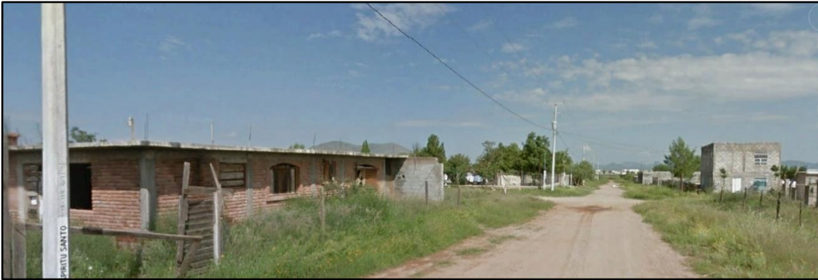
Vivienda en proceso de construcción en la colonia Granjas Del Valle I Etapa.
