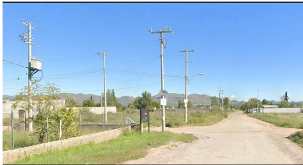
Infraestructura de energía eléctrica
