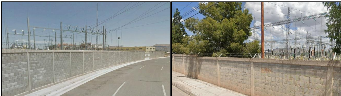
Subestación Eléctrica Supra
