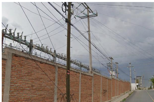
Fig. 124 –Infraestructura de Energía Eléctrica existente en el predio Fuente: Propia.
