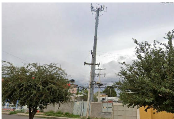
Fig. 129 – Antena de telefonía celular ubicada en C. Trasviña y Retes. Fuente: Propia.
