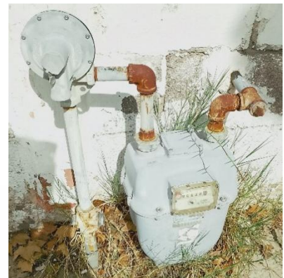
Fig. 131 – Medidor de ECOGAS ubicado en predio. Fuente: Propia.
