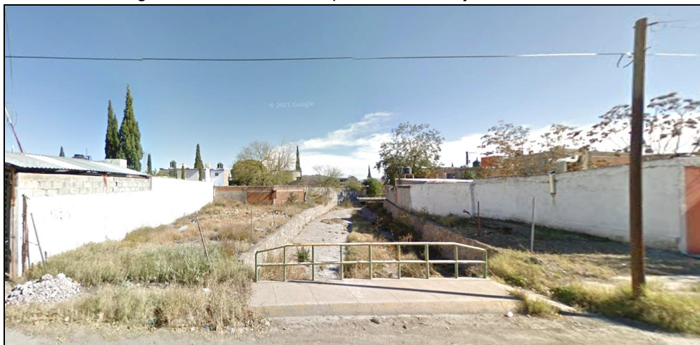
Imagen 56. Escurrimientos pluviales al arroyo La Galera sur.
